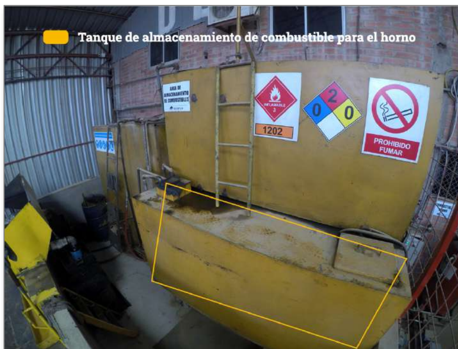
Figura 18. Tanque de almacenamiento de combustible para el horno.
