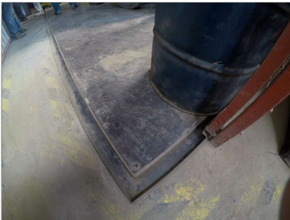
Anexo 38. Canaletas para conducir derrames a la fosa de retención.
