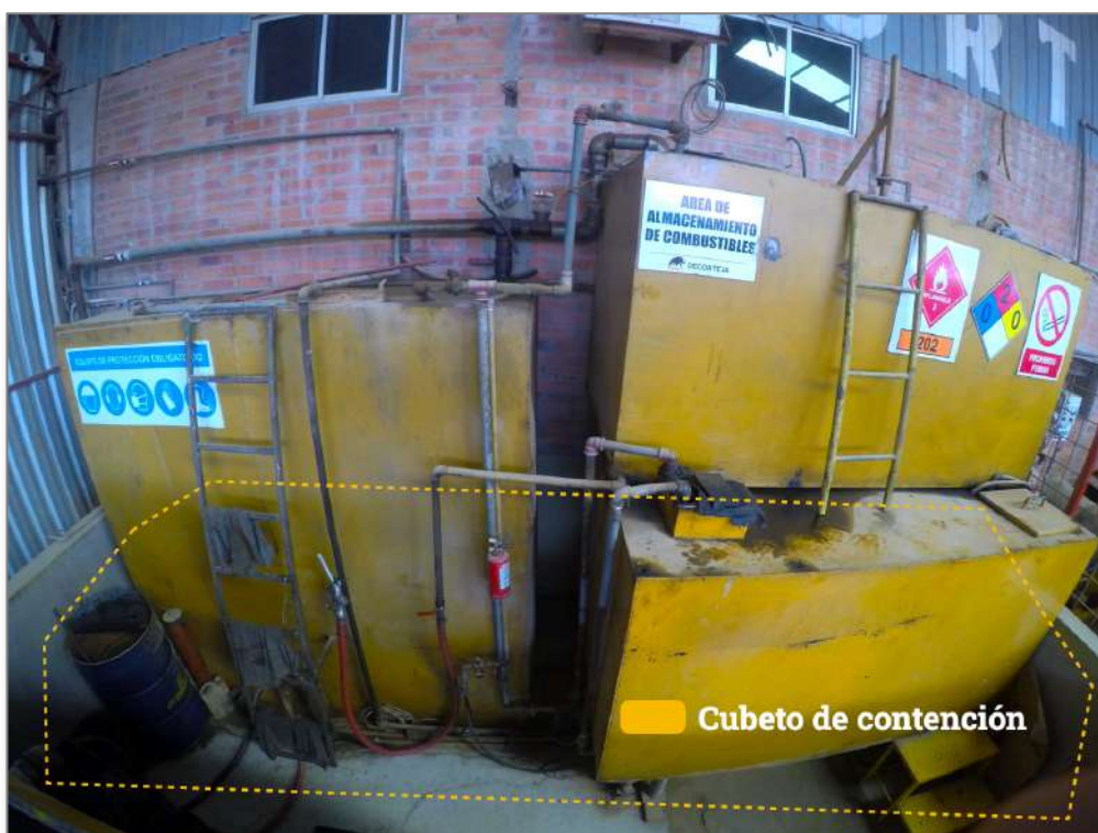
Figura 19. Cubeto de contención para el almacenamiento de los desechos peligrosos.
