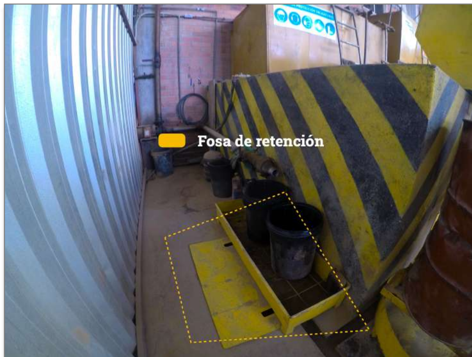
Anexo 39. Fosa de retención de derrames.
