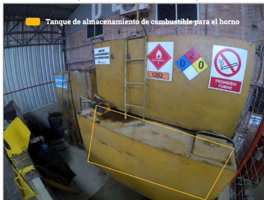
Anexo 37. Tanque de almacenamiento de combustible para el horno.
