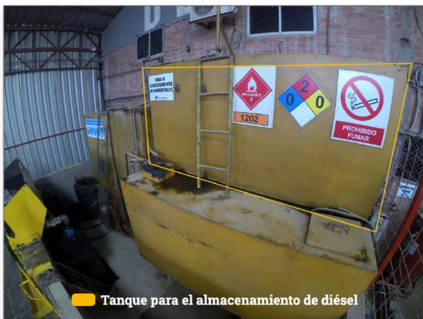
Figura 17. Tanque para el almacenamiento de diésel.
