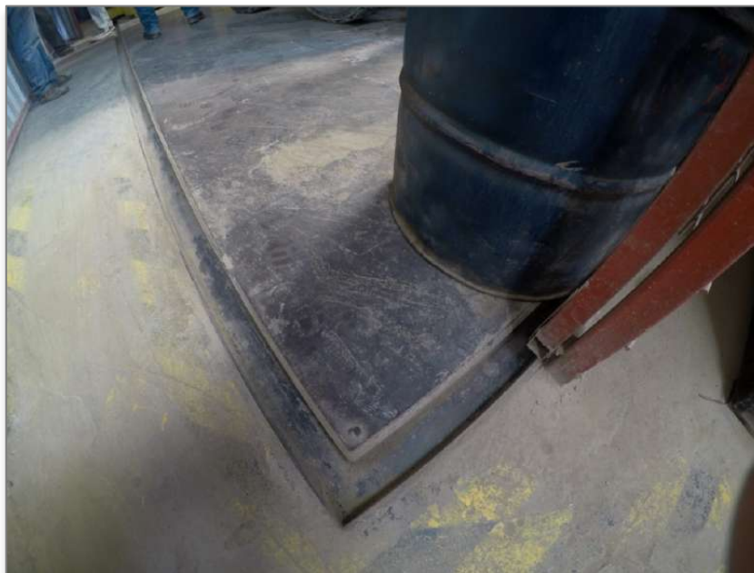
Figura 20. Canaletas para conducir derrames a la fosa de retención.
