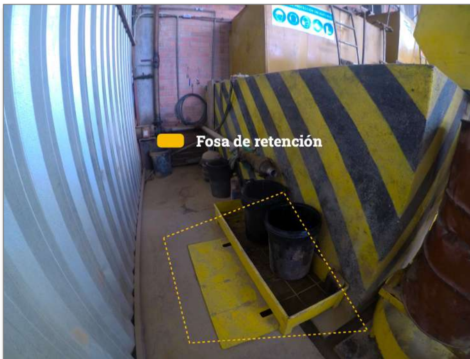
Figura 21. Fosa de retención de derrames.
