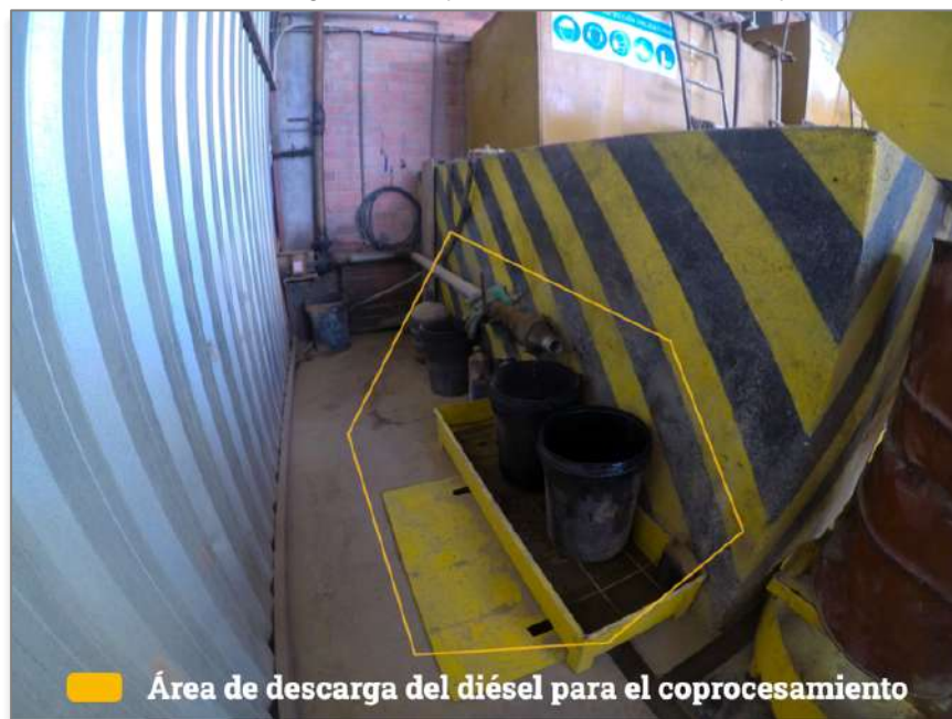
Anexo 36. Área de descarga del diésel para alimentar el sistema del coprocesamiento.
