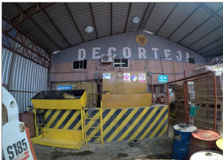
Figura 12. Área de Almacenamiento y parte del sistema de coprocesamiento del Aceite Usado.
