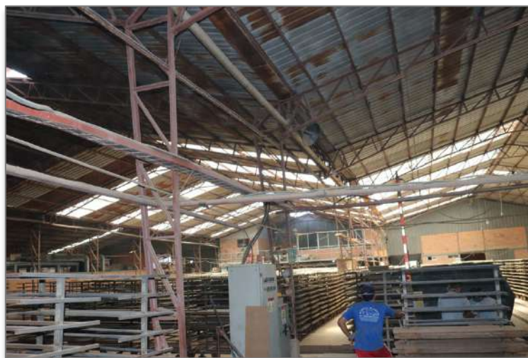
Figura 37. Cableado eléctrico aéreo.
