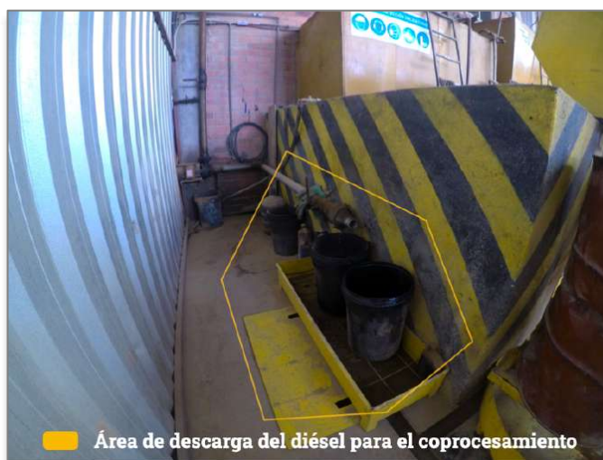
Figura 13. Área de descarga del diésel para alimentar el sistema del coprocesamiento.
